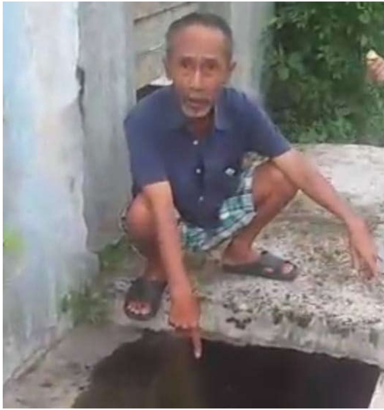
BOCOR. Seorang warga Ciktim menunjukkan pipa milik Perumdam Tirta Anom Kota Banjar yang bocor.
